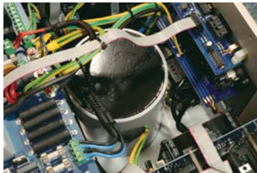
△以環氧樹脂 (Epoxy) 灌封的圓桶內藏了 3 個變壓器，分別供電給邏輯電路及保護線路等，還有 2 個 150VA 音響專用環型變壓器負責供電給訊號輸入電路和增益級。
